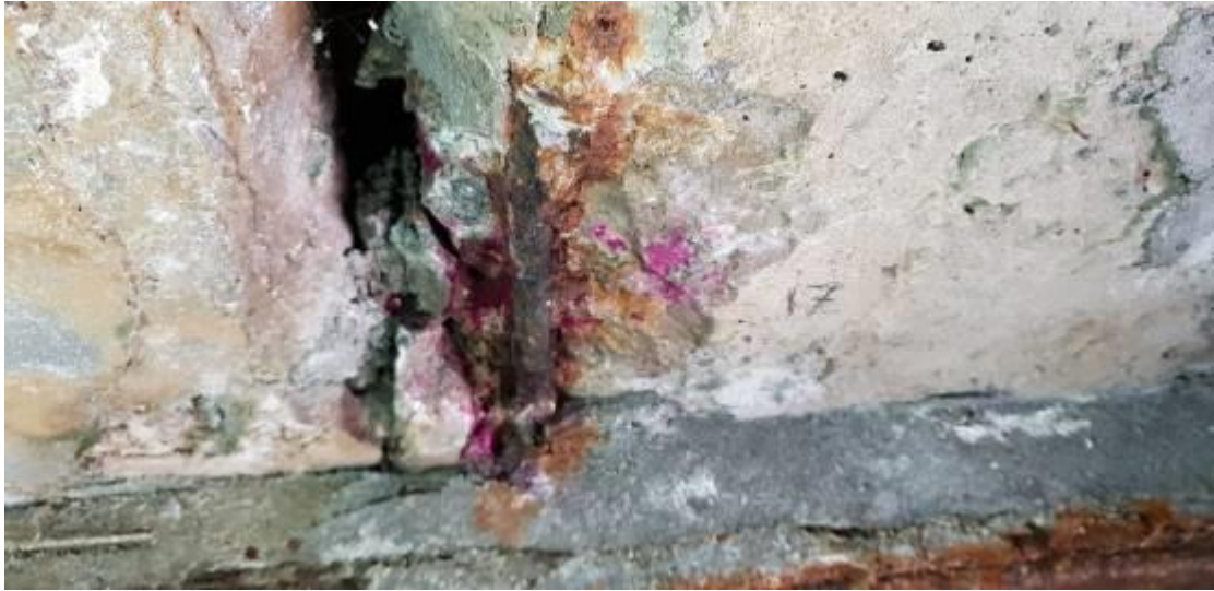
Рисунок 4 – Карбонізація бетону і зменшення перерізу арматури до 70 відсотків
