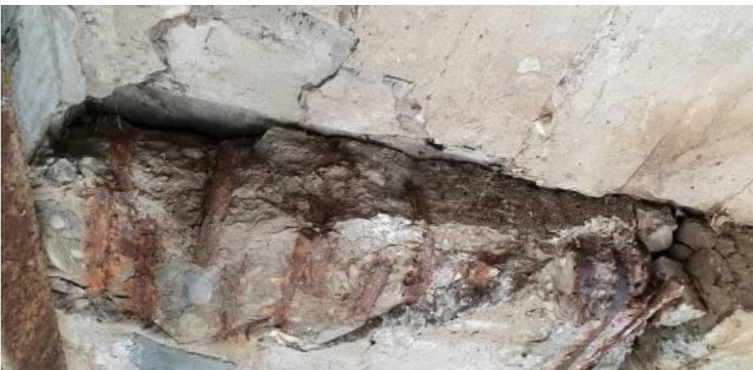
Рисунок 3 – Карбонізація бетону та корозія арматури
