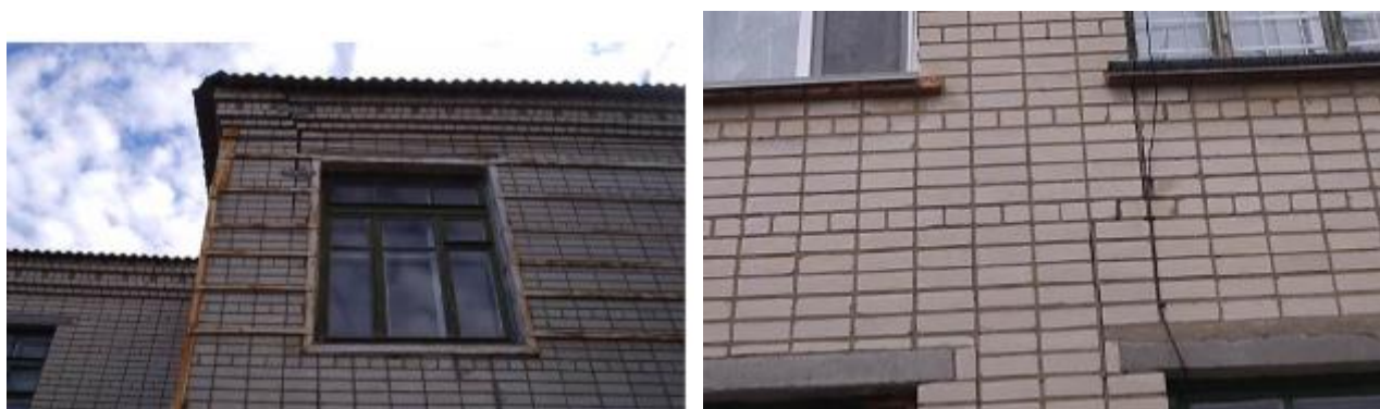
Рисунок 1 – 2 - Фотофіксація тріщин в цегляній кладці (1 - по осі К в осях 4-3; 2- по осі А в осях 3-4)
