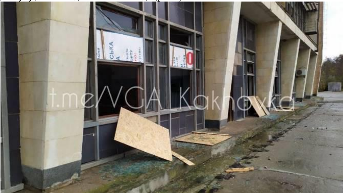
Рисунок 2- Пошкодження на ГНС УГКМК від обстрілів, 18.11.2022
