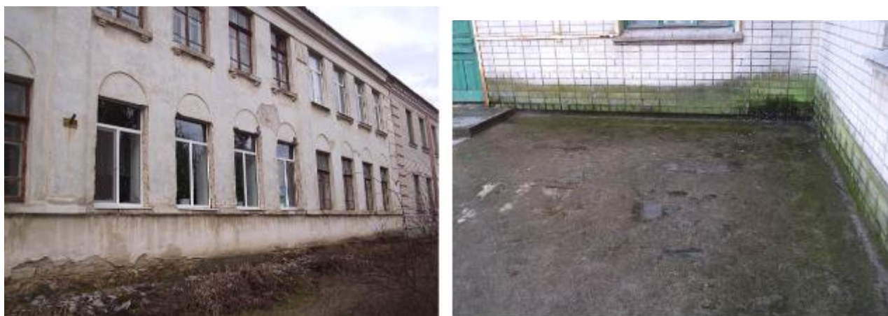
Рисунок 3 – 4 - Фотофіксація дефектів відмостки
