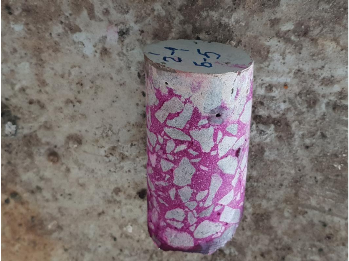
Рис. 3. Карбонізація бетону до 20 мм. Керн вибурений з тіла бетону балки Б-5 біля опори 2.
