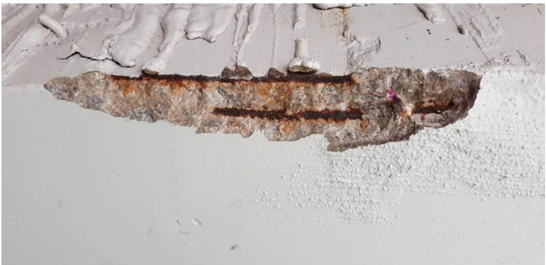
Рис.3. Відшарування захисного шару бетону, оголення та корозія арматури плити балки. Карбонізація на глибину розкриття
