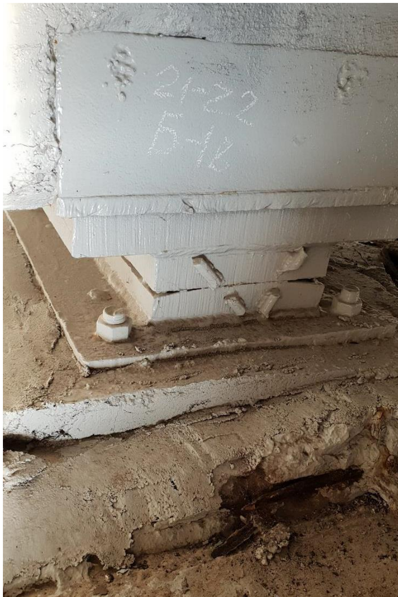
Рис.1. Оголення, корозія арматури підферменної частини ригеля опори балки Б-1.
