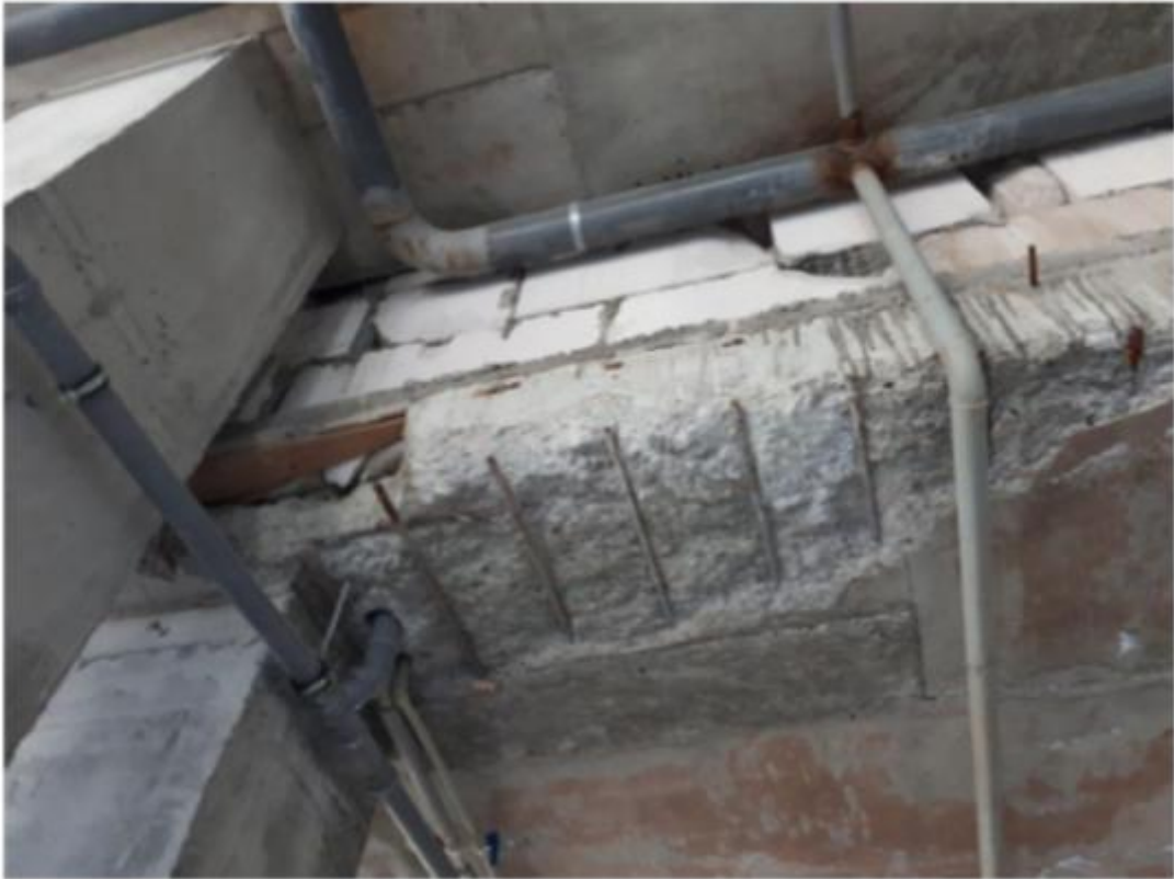
Рис. 2. Фрагмент монолітного перекриття. Порушений захисний шар бетону, оголена арматура.
