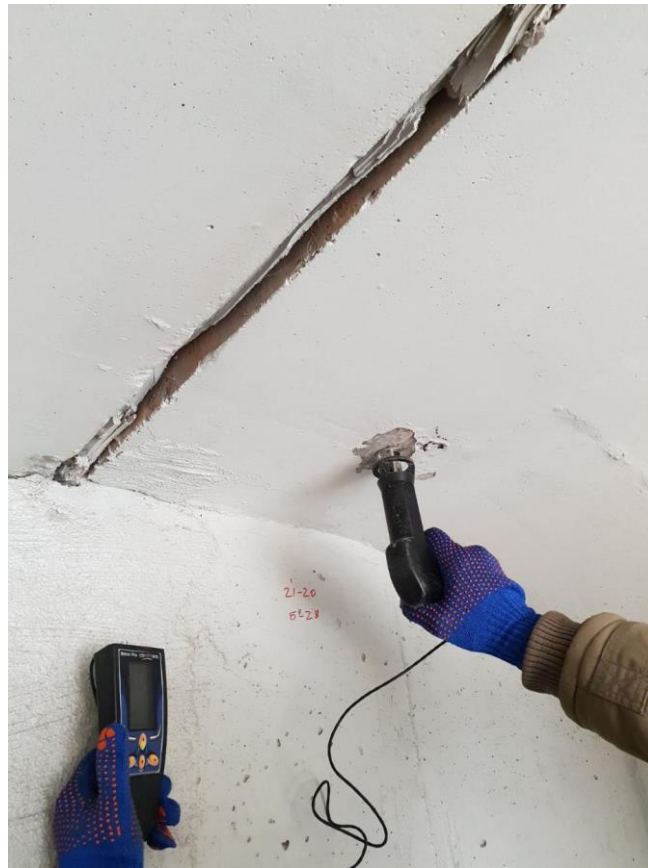
Рис. 2. Визначення міцності бетону полиці балки Б-2 на опорі 21 неруйнівним методом за допомогою електронного приладу Beton Pro CONDROL.
